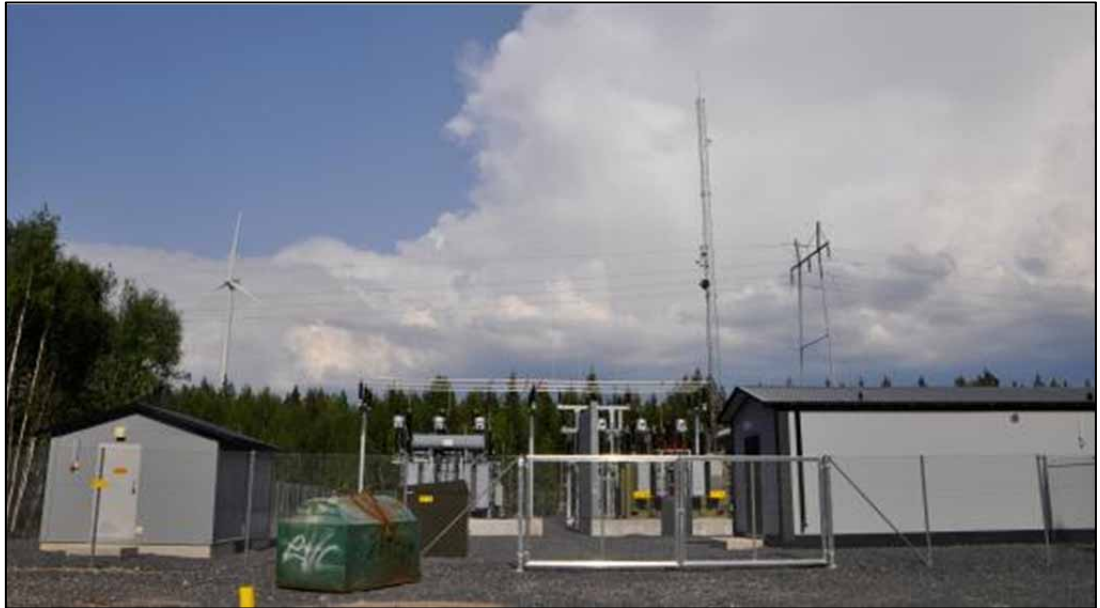
Kuva 5.8. Esimerkki tuulivoimapuiston 20/110 kV sähköasemasta. (Kuva: Leila Väyrynen / FCG).
