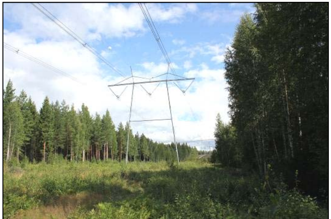
Kuva 4.11. Esimerkki 110 kV ilmajohdosta harustetulla portaalipylväällä.
