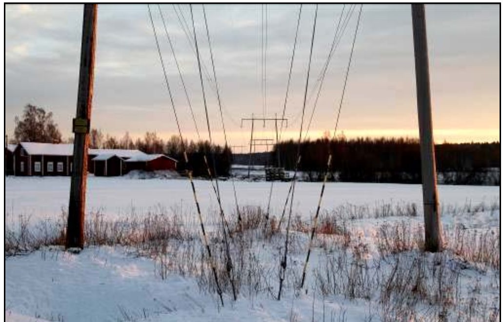
Kuva 4.14. Fingridin uusittava 220 kV voimajohto Dagsmarkin kohdalla.
