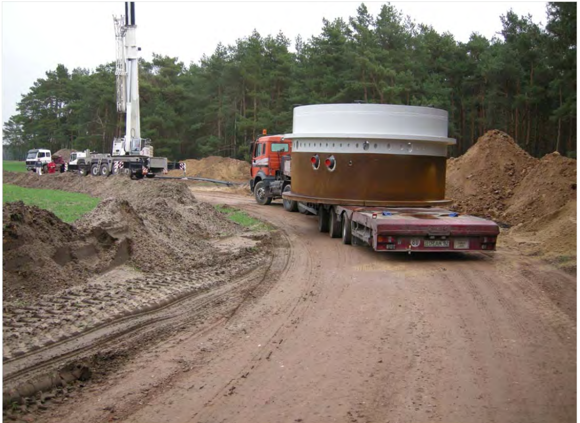
Kuva 9.2. Voimalakomponentteja varten tarvitaan noin 12-14 erikoiskuljetusta voimalaa kohden.
