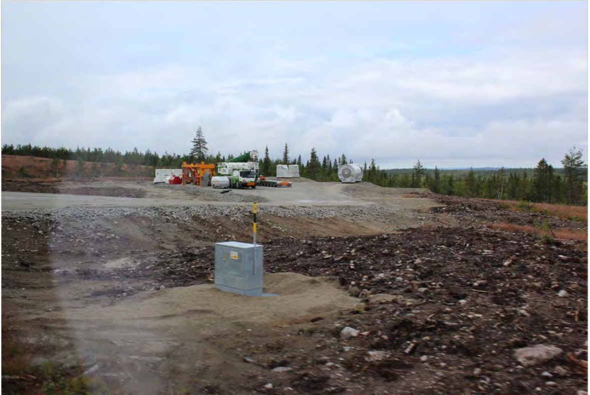
Kuva 3.45. Voimalan pystyttämisa-alue. Kuvassa näkyy muun muassa voimalan konehuone ja pienempi apunosturi Kuva: Hans Vadbäck /FCG).
