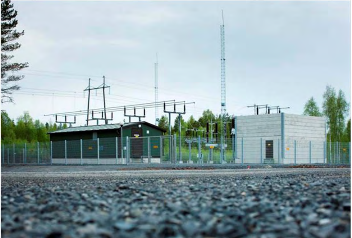
Kuva 3.21. Näkyvimmit komponentit sähköasemalla ovat suojarakennus, kytkinkenttä, ukkosmastot sekä muuntajabunkkeri (kuva VEO OY).
