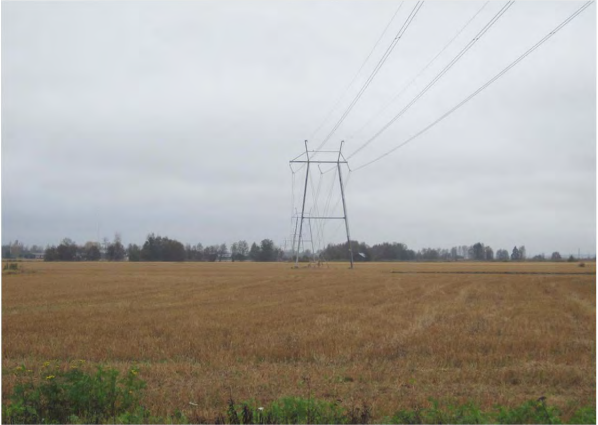
Kuva 3.23. Esimerkki harustetuilla portaalipylväillä rakennetusta 110 kV ilmajohtosta (Kuva: Janne Märsylä / FCG).
