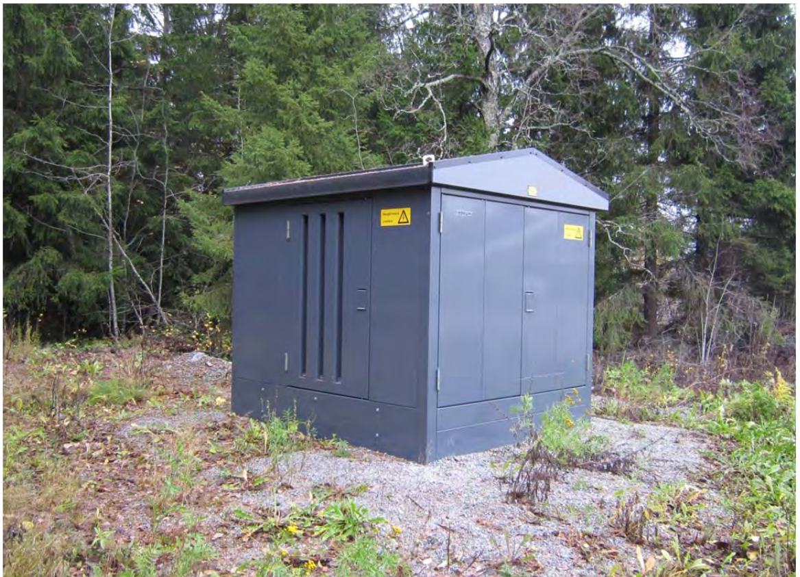
Kuva 3.20. Puistomuuntamot toimivat keskijännitekaapeleiden yhdistymispisteinä ja 1/20kV muuntajien suojarakennuksina (kuva: Janne Märsylä/ FCG).
