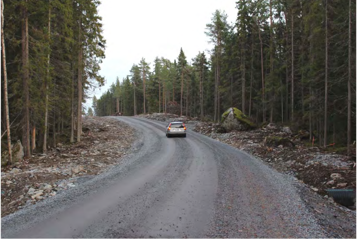
Kuva 3.18. Esimerkki tuulivoimapuiston rakennus- ja huoltotiestä. Teitä käytetään muun muassa betonin ja soran sekä voimaloiden komponenttien kuljetuksiin. Tuulivoimapuiston käyttövaiheessa teitä käytetään mm. vuosittaisissa huolloissa. Maakaapelin oja on sijoitettu tien vasemmalle puolelle (Kuva: Hans Vadbäck / FCG).
