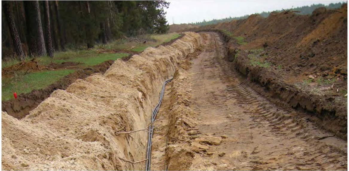
Kuva 3.19. Puiston sisäiset sähkö- ja tiedonsiirtokaapelit kaivetaan kaapeliojaan noin 0,5 – 1 metrin syvyyteen. (kuva: Erik Trast / CPC Finland Oy).
