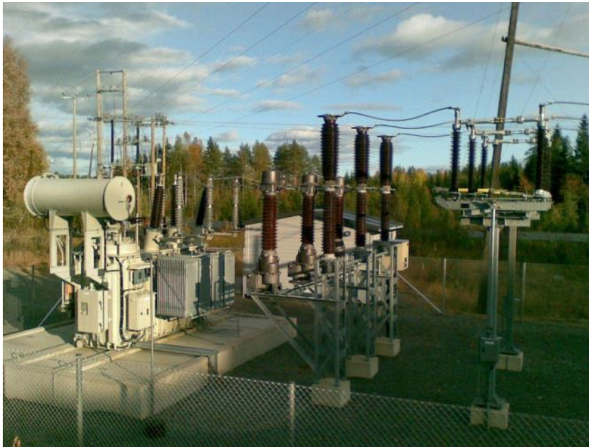
Kuva 2-9. Esimerkki tuulivoimapuiston 20/110 kV sähköasemasta.
