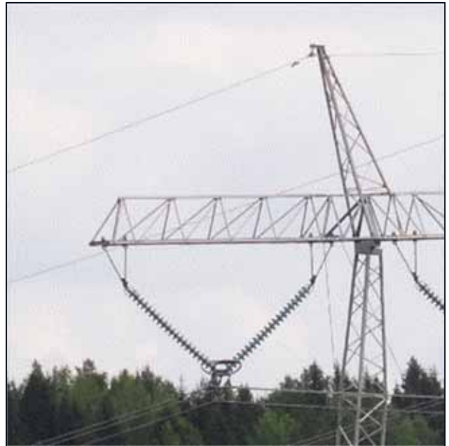
Kuva 89. Voimajohtopylvään eristimiä, joissa koronapurkauksia voi esiintyä.
