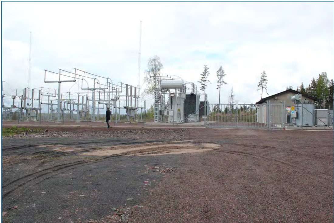
Kuva 5.10. Esimerkki tuulivoimapuiston sähköasemasta. (Kuva: Jakob Kjellman/FCG)
