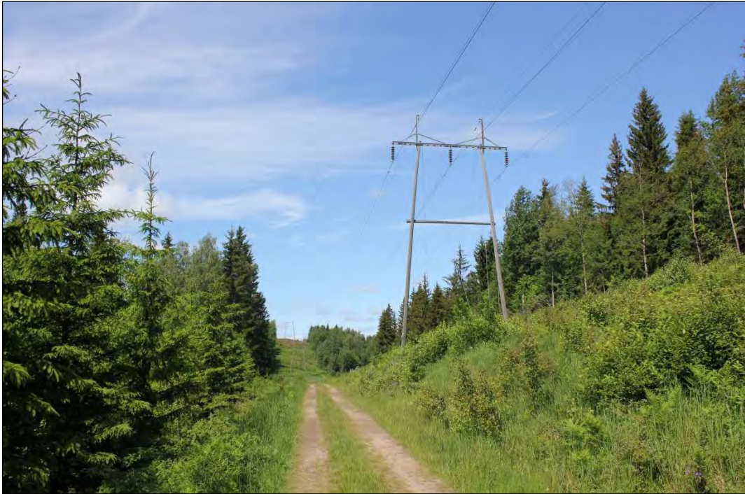
Kuva 5.13 Esimerkki 110 kilovoltin ilmajohdosta. Johtoaukealla esiintyy yleensä puun taimia ja pensasmaista kasvillisuutta (Kuva: Mattias Järvinen / FCG).
