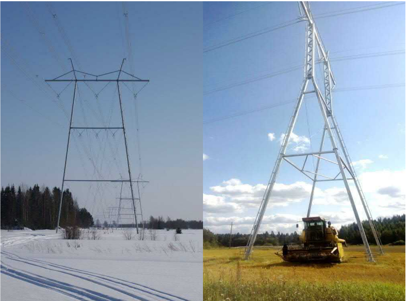
Kuva 4.21. Esimerkkikuvat eri pylvästyypeistä. Vasemmalla perusratkaisun mukainen 400+110 kilovoltin haruksin tuettu portaalipylväs ja oikealla vapaasti seisova harukseton peltopylväs.
