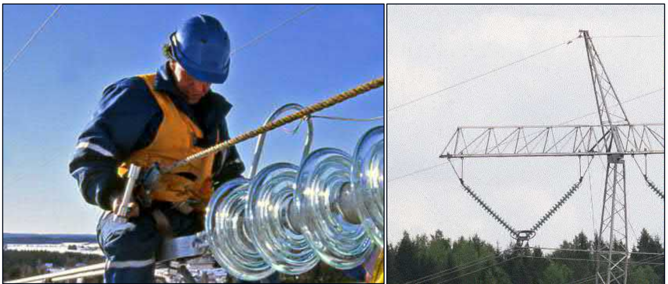
Kuva 11.3. Voimajohtopylvään eristimiä, joissa koronapurkauksia voi esiintyä.
